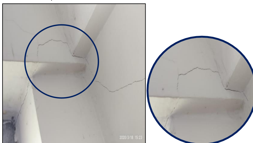
Figura 06. Fissuras de recalque diferencial
