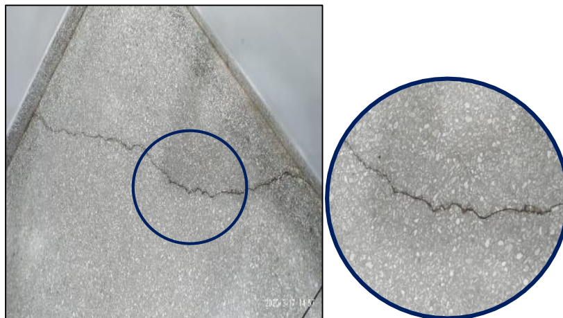
Figura 03. Fissuras de momento volvente
