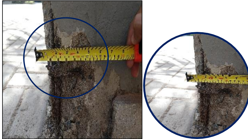
Figura 07. Desagregação do concreto
