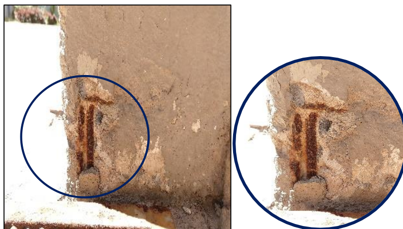
Figura 08. Corrosão da armadura
