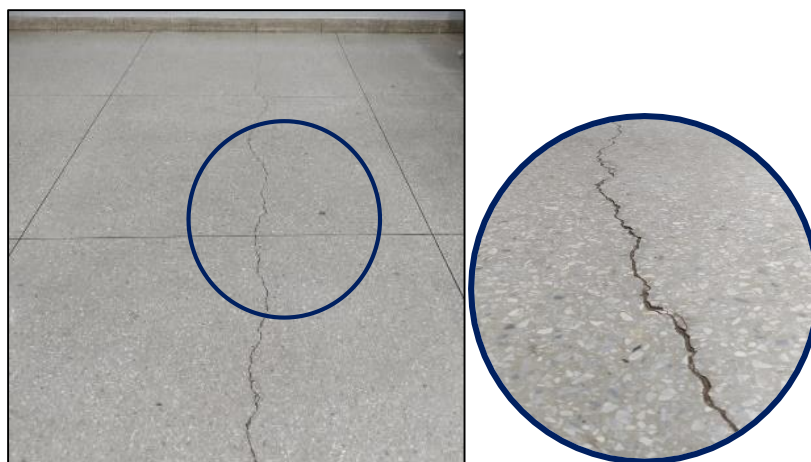
Figura 04. Fissuras/trincas de retração
